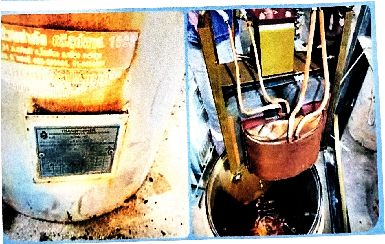
รูปภาพหม้อแปลง TR๒๓-๐๐๐๙๐๔ ๒๐KVA
