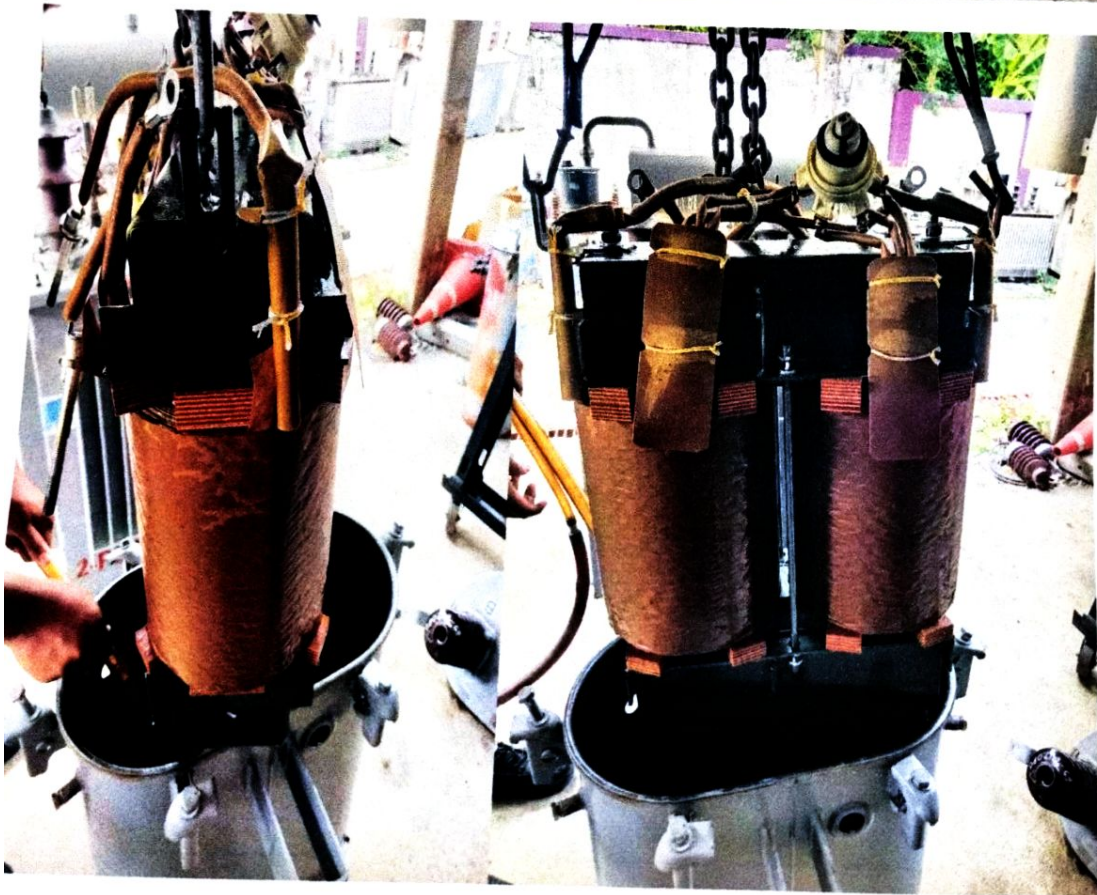
รูปภาพหม้อแปลงTR๖๕-๐๑๗๐๘๐ ๓๐kVA
